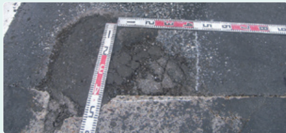
路面損傷の例
