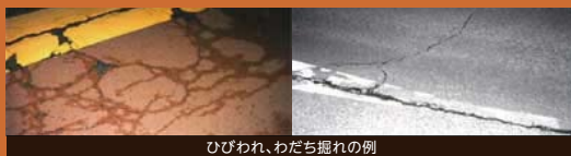
ひびわれ、わだち掘れの例
