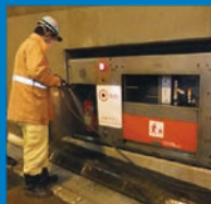
泡消火栓点検
