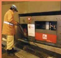
泡消火栓点検
