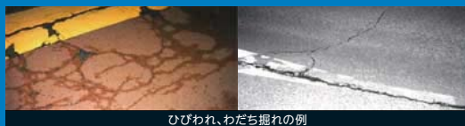
ひびわれ、わだち掘れの例
