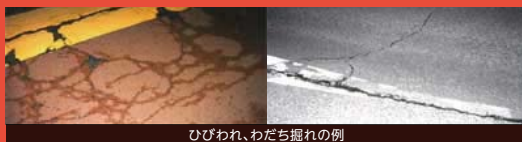
ひびわれ、わだち掘れの例
