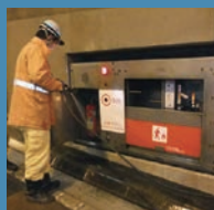
泡消火栓点検
