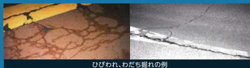
ひびわれ、わだち掘れの例
