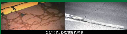
ひびわれ、わだち掘れの例
