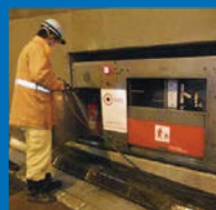
泡消火栓点検
