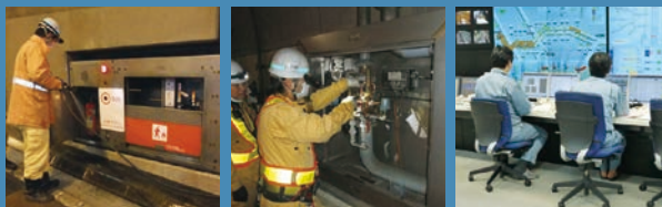
泡消火栓点検
