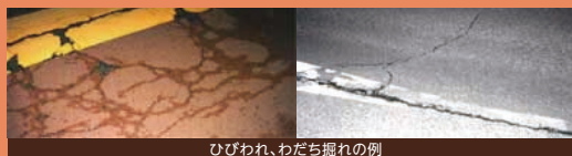
ひびわれ、わだち掘れの例
