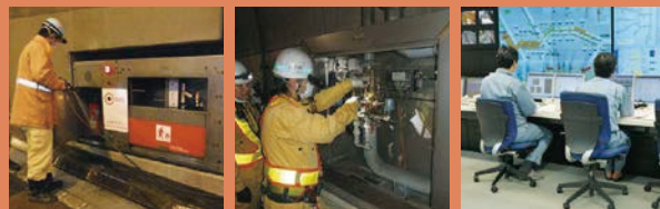
泡消火栓点検
