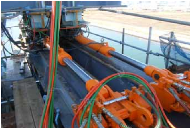
- 3 横取り設備 ( - 1,2の設備)
