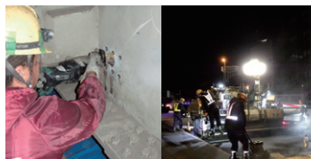
損傷に対する補修の実施：年間約3.4万件
