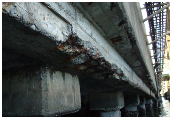
海水により激しく損傷した構造物
