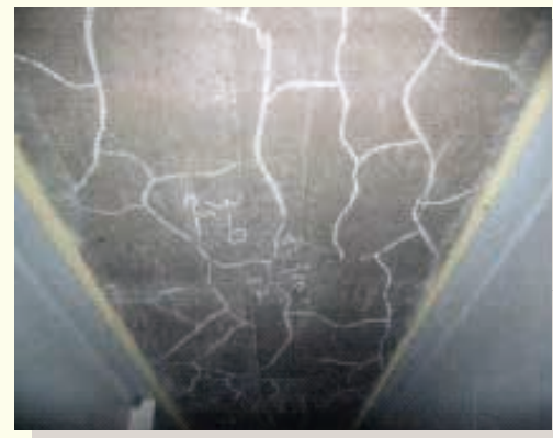
損傷状況 (コンクリート床版の亀甲状ひび割れ)
