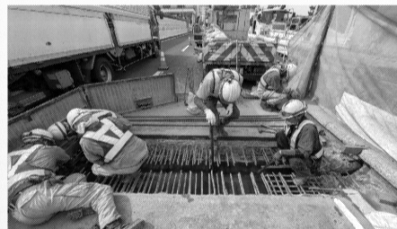
補修工事の際は、交通量の少ない時間帯に行き、複数の工事を集約するなど、交通への影響を最小限に抑える工夫をしている
