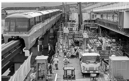
狭いスペースでの更新工事(1号羽田線「東品川橋・鮎洲埋立部」)
