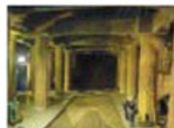
（生麦中学校舎地下部） 校舎の基礎杭がトンネルの支障となるため、地下部分を掘削し、その基礎杭を新しい杭に受替える工事を実施しています。
