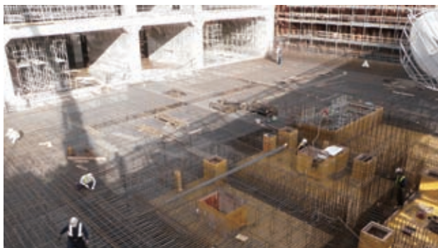
④ トンネル・換気所・受変電棟部 (換気所部鉄筋組み立て状況)
