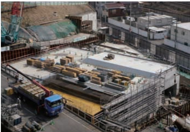
④トンネル・換気所・受変電棟部（受変電棟部を西側から眺む）
