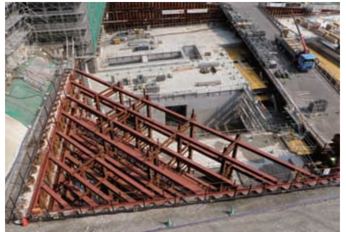
③トンネル・換気所・受変電棟部（換気所部を西側から眺む）
