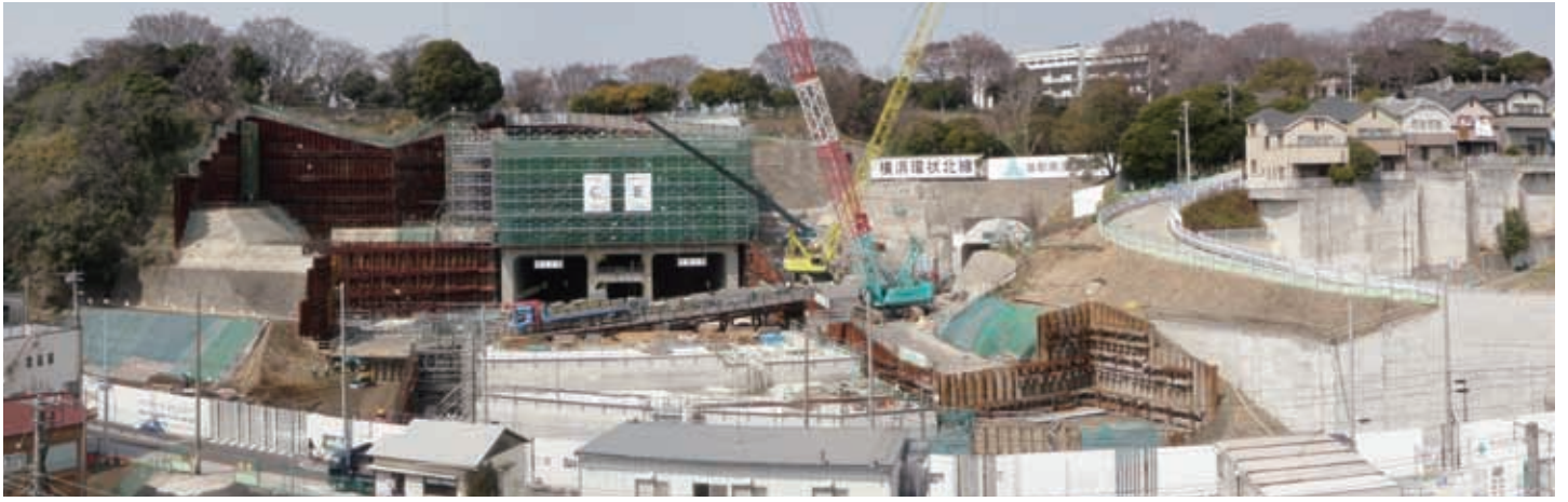
<横浜環状北線>①トンネル・換気所・受変電棟部（学園通り側から眺む）
