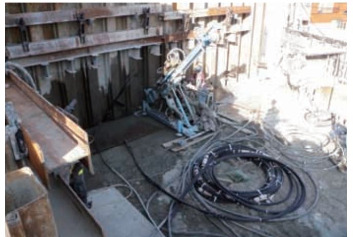
⑤トンネル・換気所・受変電棟部（橋台部アンカー設置状況）
