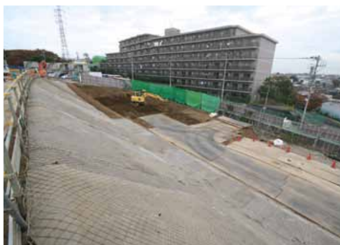
⑤ 馬場出入口トンネルヤードトンネル発進部(基盤整備状況)
