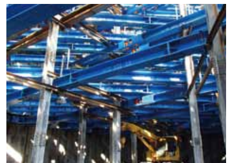
④ 馬場出入口トンネルヤード トンネル発進部(掘削状況)
