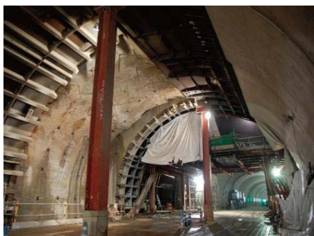
③ シールド工事状況 (本線シールドトンネル拡幅工事状況)
