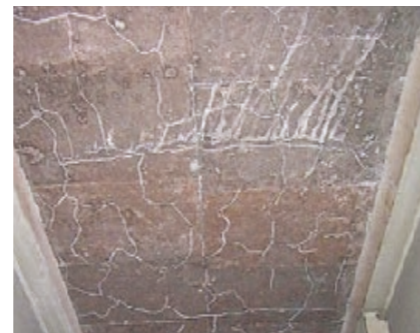
コンクリート床版の亀甲状ひび割れ
