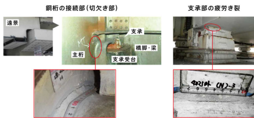
き裂の進展を抑制するため応急補修を実施済
