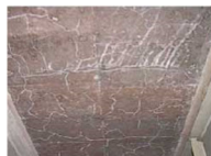
コンクリート床版の 亀甲状ひび割れ
