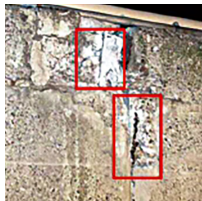
擁壁の損傷状況 (コンクリート剥離・鉄筋腐食)
