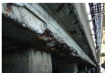
桁下と海水面が近接しており、維持管理が困難
