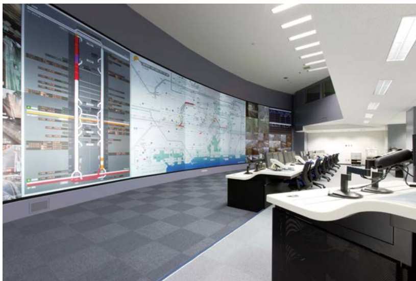
交通管制室の様子
