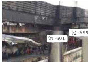
事故直後の状況
