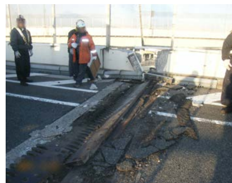
大黒JCT連結路の路面損傷状況
