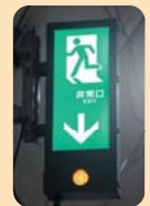
非常口表示灯
