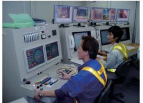
写真は中央環状新線シールド工の中央制御室です。
