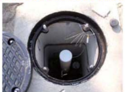
地盤変動計測器設置事例
