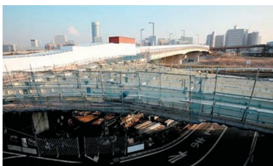
③-1 長島大竹線センターランプ橋桁架設状況 (新横浜駅方面を眺む)
